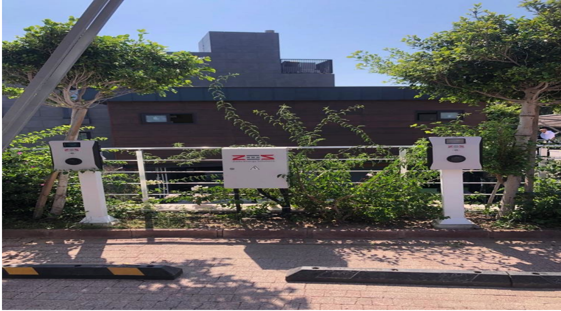
Elektrikli Araç Şarj İstasyonu
