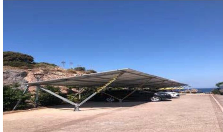
Güneş Enerji Sistemi
