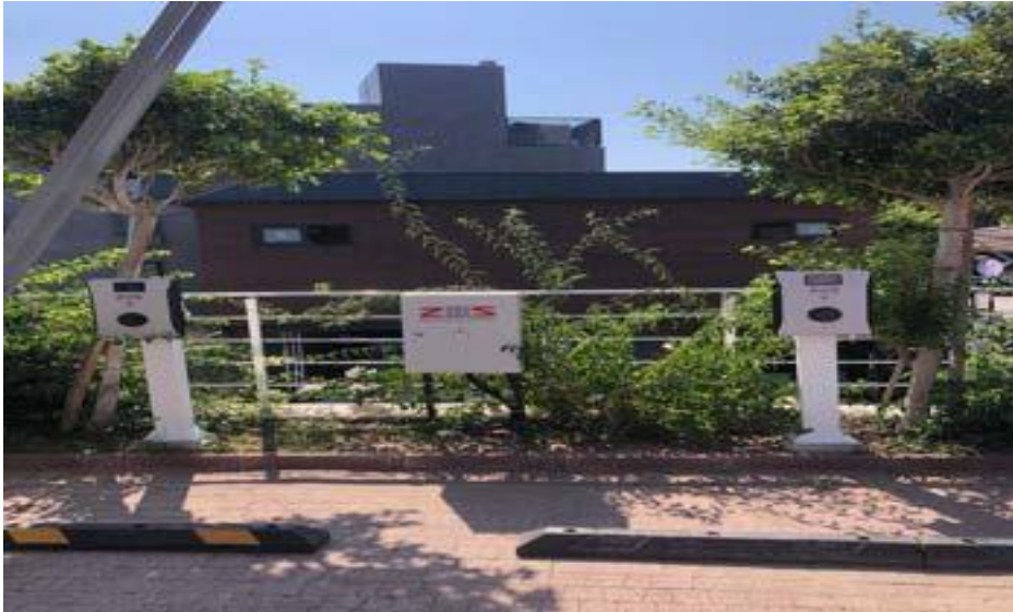
Elektrikli Araç Şarj İstasyonu
